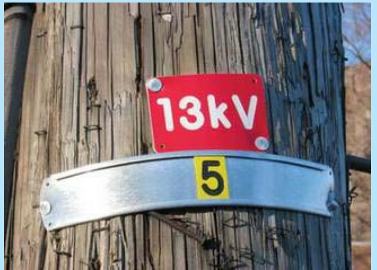
ในบางท้องถิ่นตรงโคนเสาจะมีป้ายบอกจำนวนสายไฟและจำนวนโวลต์ของสายแต่ละเส้นซึ่งนักดับเพลิงสามารถนำไปเป็นข้อมูลในการวางแผนการทำงานที่ปลอดภัยได้
