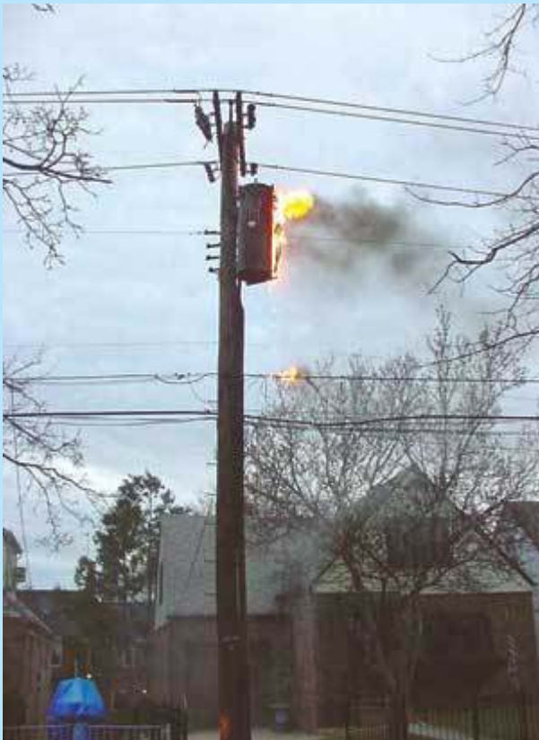
ไฟไหม้หม้อแปลงที่ติดตั้งบนเสาเป็นไฟประเภท B และ C รวมทั้งเมื่อมีการตัดไฟในสายแล้ว ให้ใช้หม้อแปลงเอนกประสงค์ทำดับไฟ
